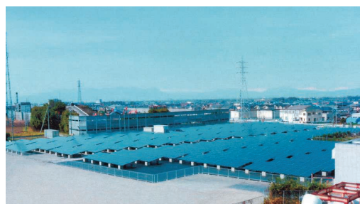
ぺんぎんメガソーラー発電所(埼玉県本庄市)
